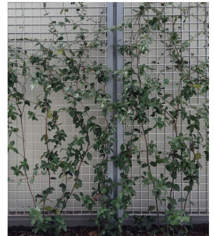
esempio di rivestimento per la cabina Enel rivestita con pannelli in acciaio zincato e rampicanti
