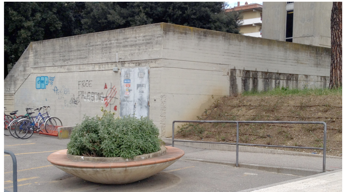
11-Vista della cabina Enel (Marzo 2014)
